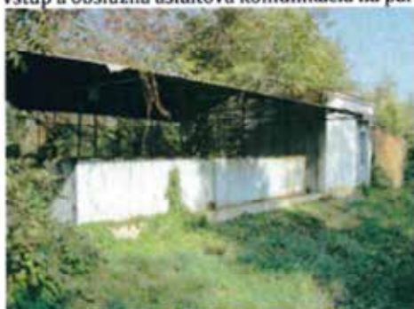
objekt - chlórOVňa vody na parc. č. 3957
